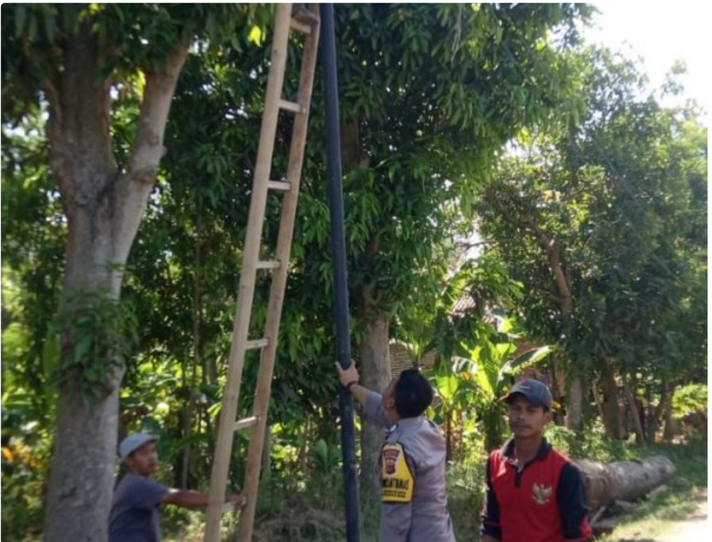
Bhabinkamtibmas Polsek Krangkeng Gotong Royong Bersama Masyarakat Lakukan Pemasangan Tiang Lampu Penerangan Jalan
